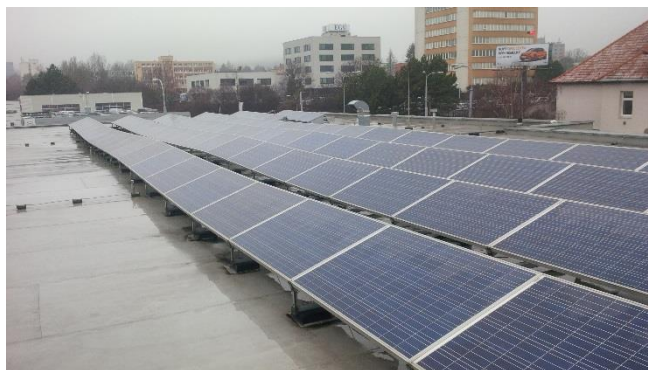
Obrázek 3.17: FVE na střeše obchodu v Brně (Zdroj: Archiv autora)
