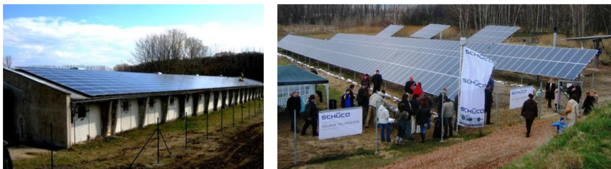
Obrázek 3.20: FVE na střeše bývalé drůbežárny v Opatově na Svitavsku (vlevo) a první etapa FVE v Dubňanech na Hodonínsku (vpravo) [49]
