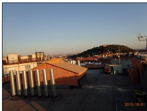
Vyústění komínů a odvětrání
