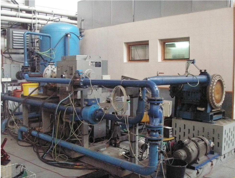
8.2.1.1 – Měřicí trať se zakomponovaným ventilem.
