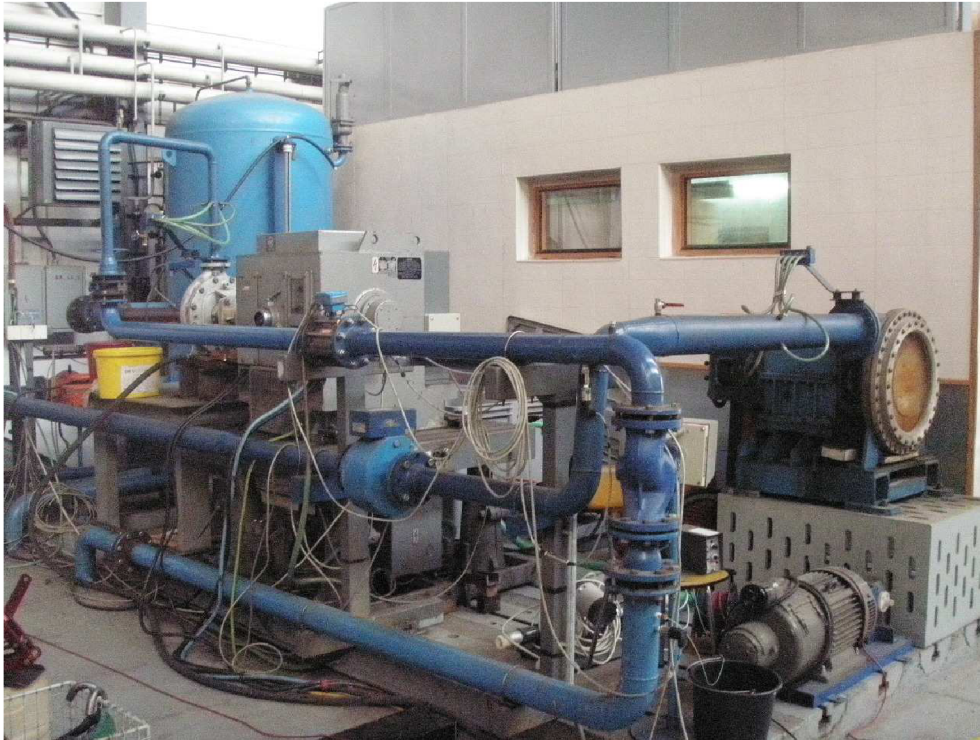
8.2.1.1 – Měřicí trať se zakomponovaným ventilem.
