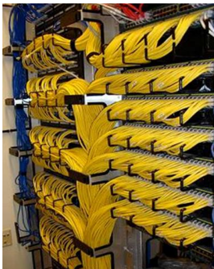
Obr. 2.2 Příklad řádně vedené správy kabeláže [1]
