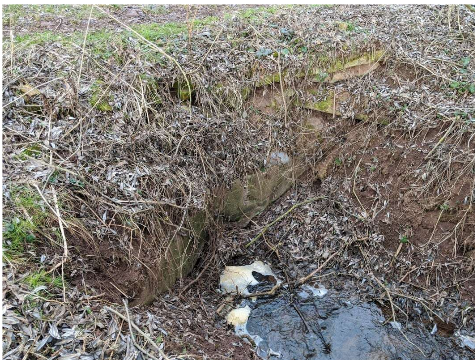
Obrázek č. 11: Zanešená betonová propust' před Malou Černocí na Černockém potoce (autor: Jan Lukáš, leden 2020)
