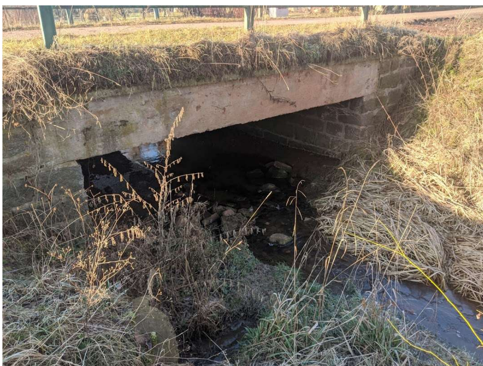
Obrázek č. 9: Most v obci Očihovec s menší průtočnou kapacitou (autor: Jan Lukáš, leden 2020)
