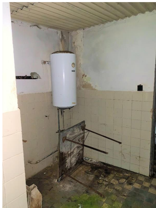
Fotografie – Umyvadlo a boiler (vlastní zpracování)
