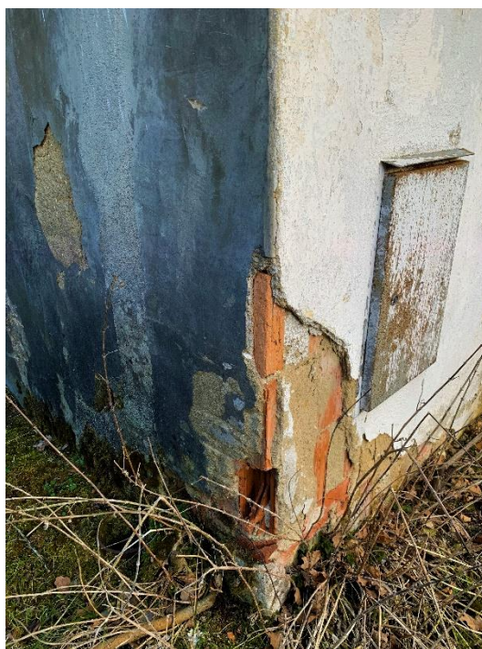
Fotografie – detail poškození rohu budovy (vlastní zpracování)
