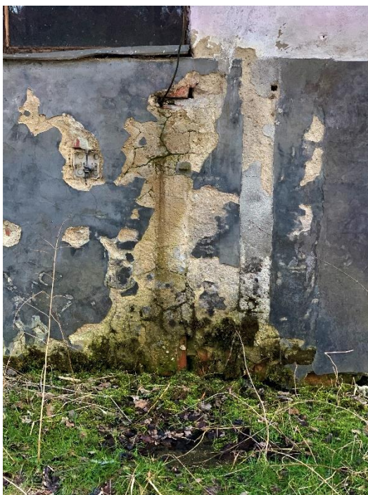
Fotografie – detail poškození zdiva (vlastní zpracování)
