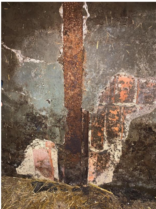
Fotografie – detail poškození zdiva a sloupu (vlastní zpracování)
