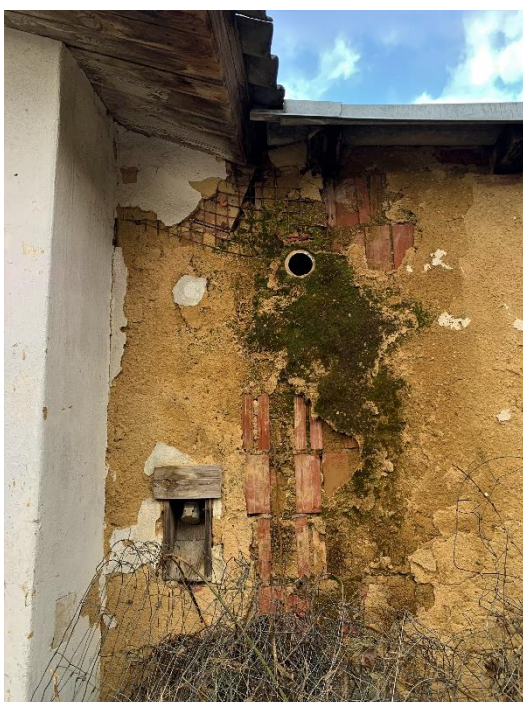
Fotografie – detail poškození zdiva (vlastní zpracování)
