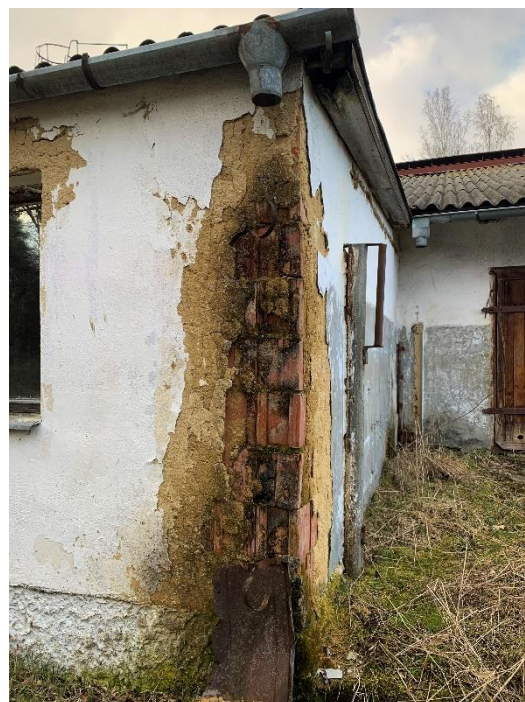
Fotografie – detail poškození rohu budovy (vlastní zpracování)
