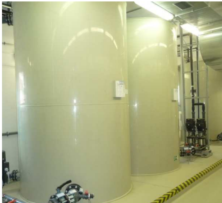
Obr. č. 14 – Zásobníky provozní vody umístěné v objektu myčky vlaků
