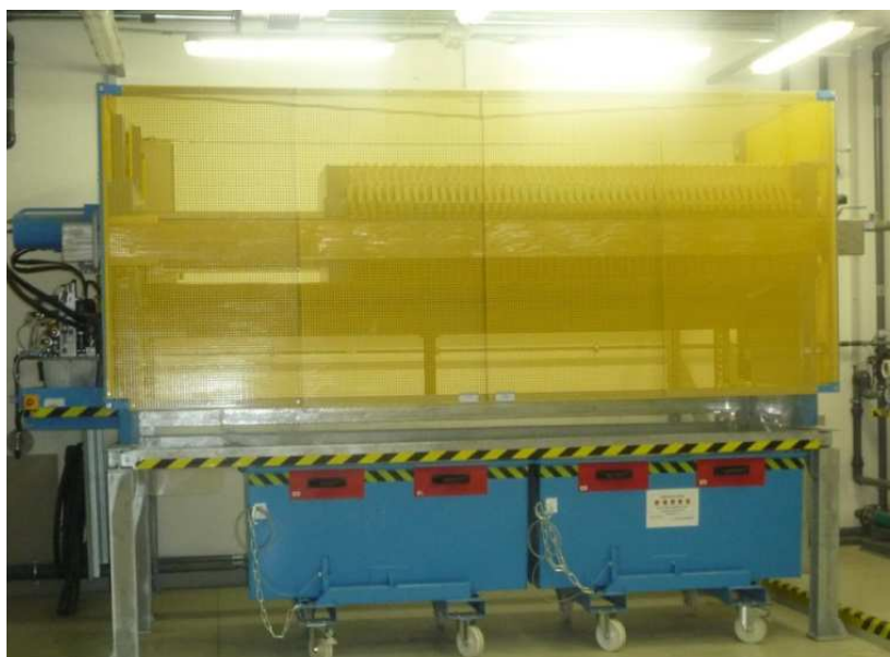
Obr. č. 13 – Komorový lis kalu uvnitř objektu myčky vlaků
