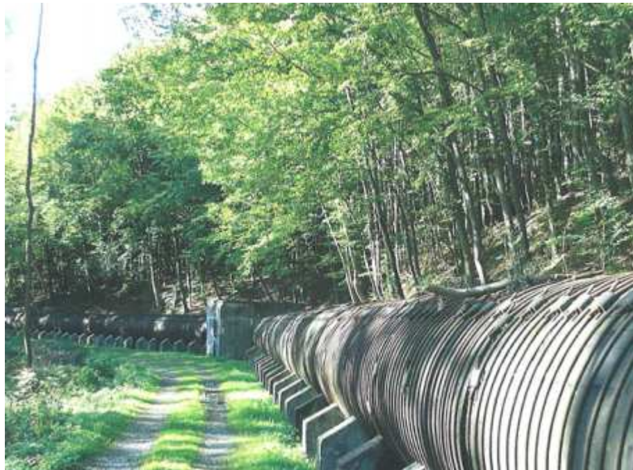
Obr. 5.5 Dřevěné dužinové potrubí DN 2000, převaděč z vodního díla Seč na vodní elektrárnu (v roce 2010 nahrazeno ocelovým potrubím) [2]
