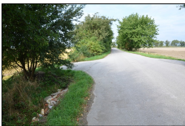
Foto. č. 46 Příkop podél cesty H 9 v neodpovídajícím stavu – nepořádek.
