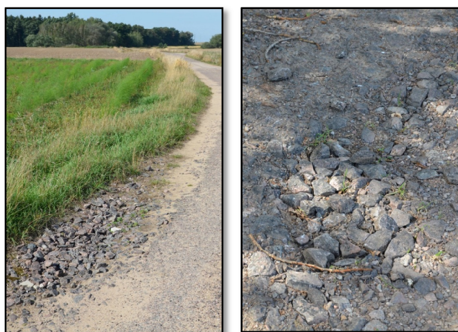
Foto. č. 2 a 3 Poškozený a opravovaný povrch cesty P3.
