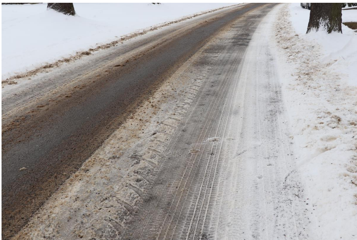
Obr. 34: Tmavě zbarvená sněhová pokrývka na frekventované silnici i podél ní, kde se během zimy sype posyp se solenkou. Uvnitř silniční komunikace se sněhová pokrývka nevyskytuje.
