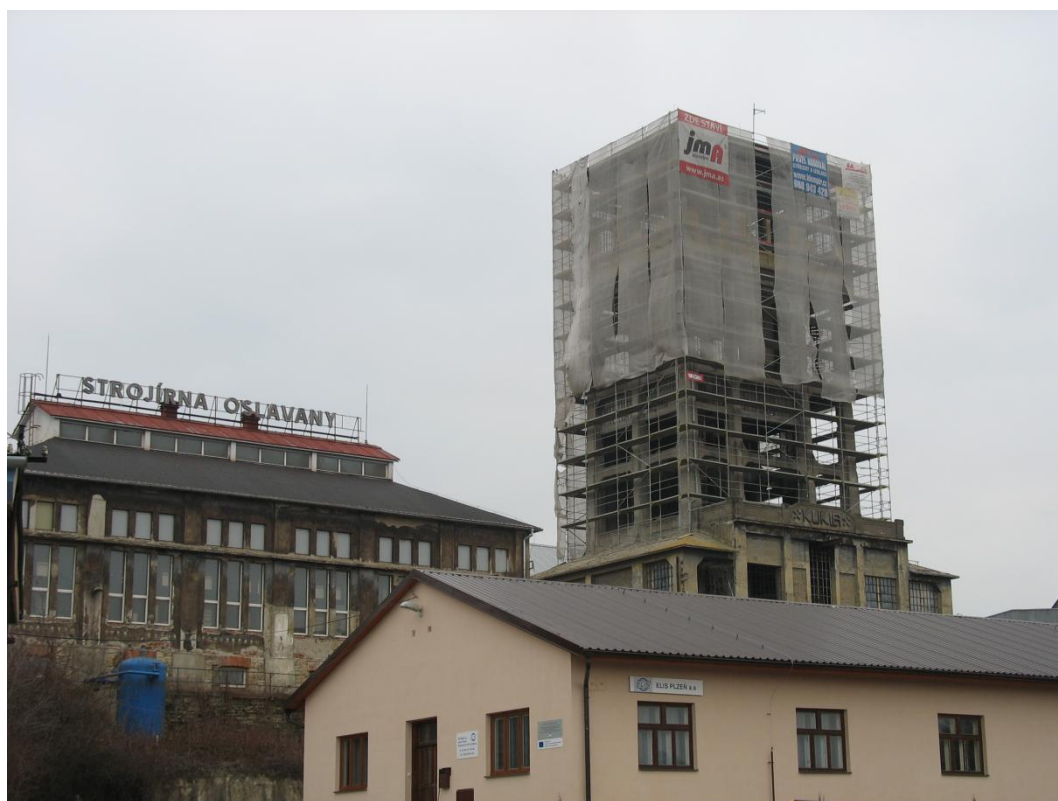
Rekonstrukce těžní věže dolu Kukla – V. Nosek, Oslavany, 2011 (foto Hana Staňková)
