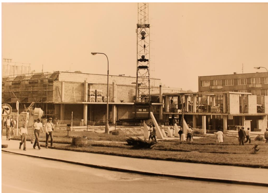
58. M. Klimek: Stavba první a druhé etapy obchodního domu Libín v Prachaticích, srpen 1983. In: Státní okresní archiv Prachatice, Fotografie — Prachatice, KT 15, Výstavba OS „Prior“ (Libín)1978–1985
