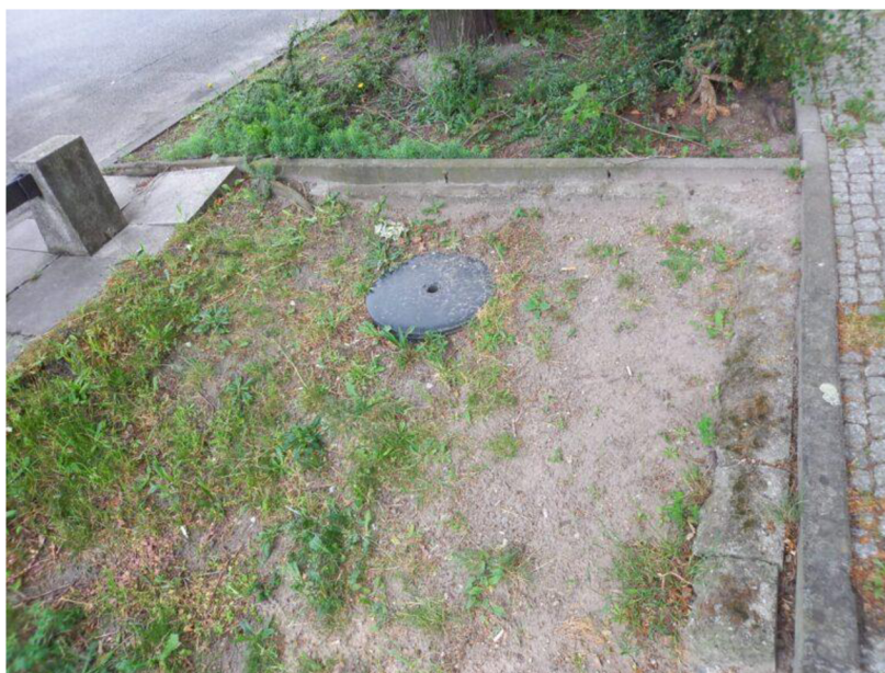
Obrázek 10: Bezpečnostní svod do kanalizace (pocitamesvodou.cz, 2022)
