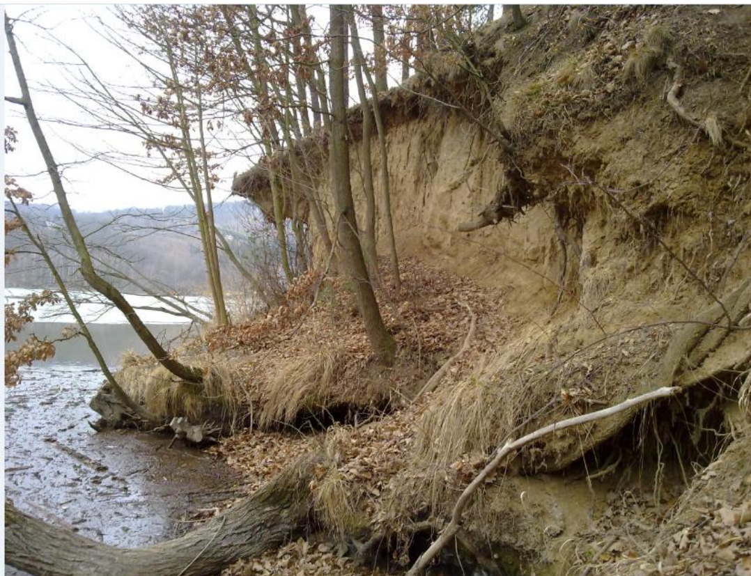
Obr. 2.1.1.7 Pohled na poškozené svahy ze zátoky
