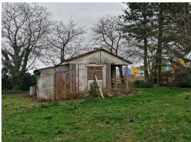
Obrázek číslo 33 – rozpadající se chata v ulici Konečná, k. ú. Strašín u Říčán Zdroj: Vlastní fotodokumentace, dne 16. 3. 2020
