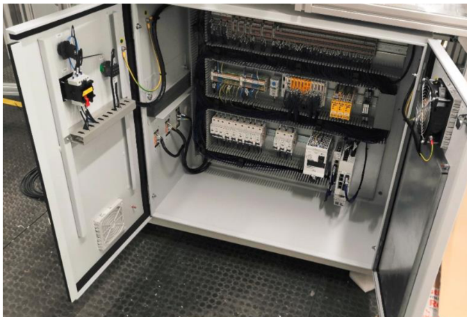
Obr. 84) Reálná podoba rozvaděče
