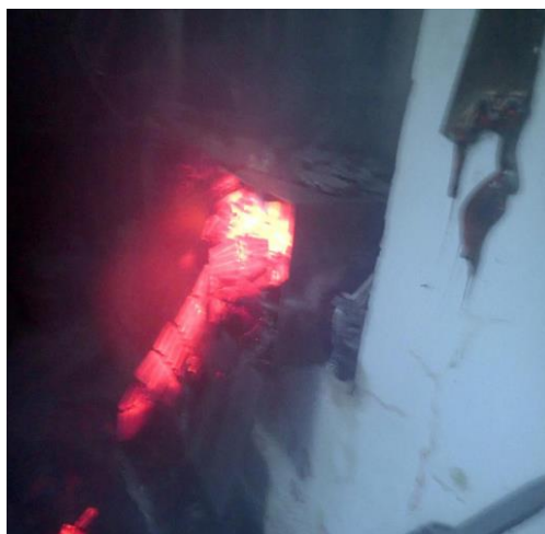
Obr. 20 – Hořící bateriové uložístě [42]
