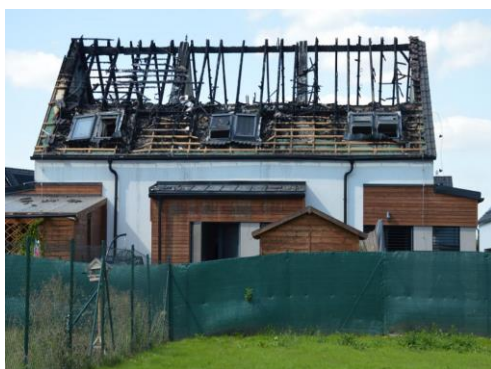
Obr. 25 – Dům po uhašení požáru [45]
