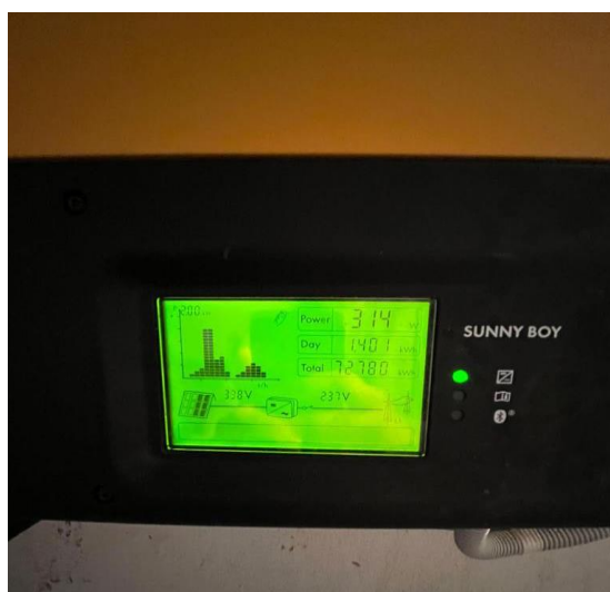
Obr. 5 - Display střídače umístěného ve sklepě [foto autor]
