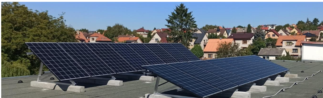
Obr. 12 – Instalace na rovné střeše přichycena do betonových kvádrů [12]
