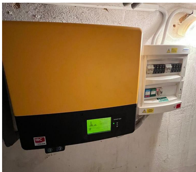
Obr. 4 - Střídač umístěný ve sklepě [foto autor]
