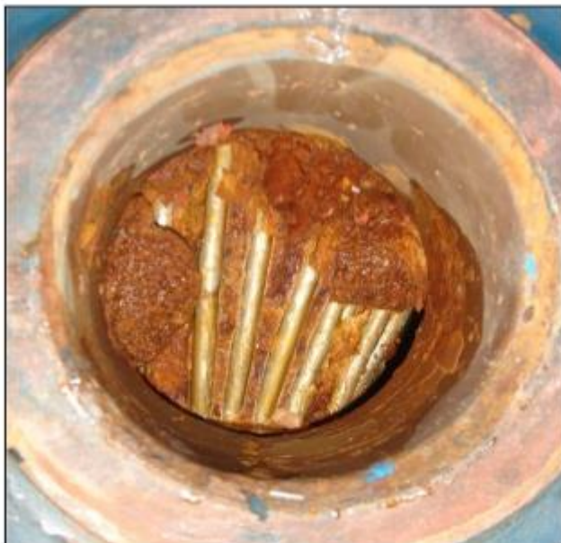
Obr. 12 Poškozený výměník korozí a usazeninami [8]
