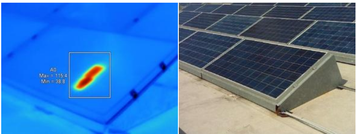
Obrázek 14: Vadné články na fotovoltaickém panelu, teplota přesahuje vysoko nad 100 °C [36]
