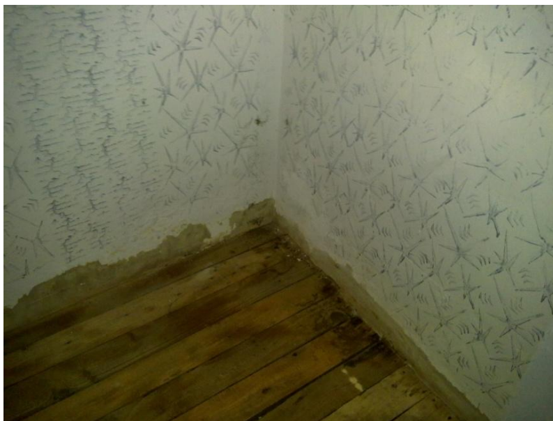
Obrázek 17: Plíseň na vlhké stěně, pokročilé stádium
