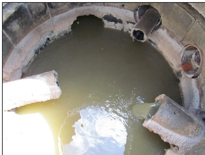
Obr.č.4.1 Výustná šachta na ČOV
