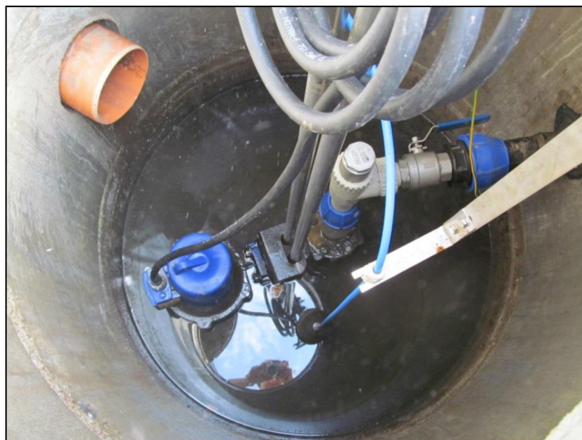
Obr.č.3.6 Domová čerpacia jímka v obci Hrádek
