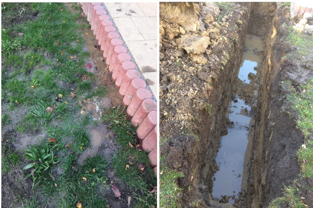
Obrázek 66: Zaznamenání zjevného úniku na vodovodu v Komořanech (vlevo) a následný výkop (vpravo)
