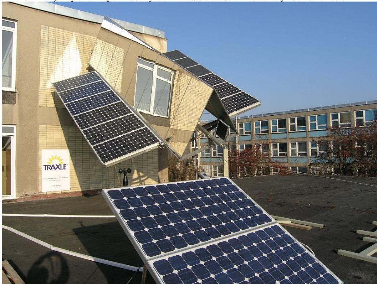
Příloha 1: Pohyblivý solární systém otočný s koncentrátorem záření instalovaný na ČZU v Praze
