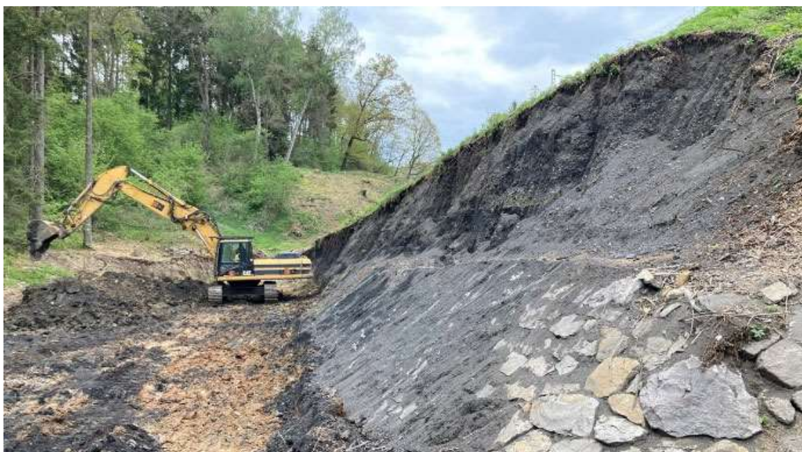
Obrázok 4.6: Príťažovacie lavice v päte svahu, objavené pri prevádzaní zemných prác, zakryté vrstvou škvary [9].
