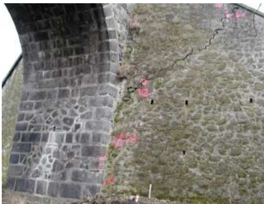
Obrázok 4.13: Poškodenie ľavého krídla mostu v km 190,286 [16].
