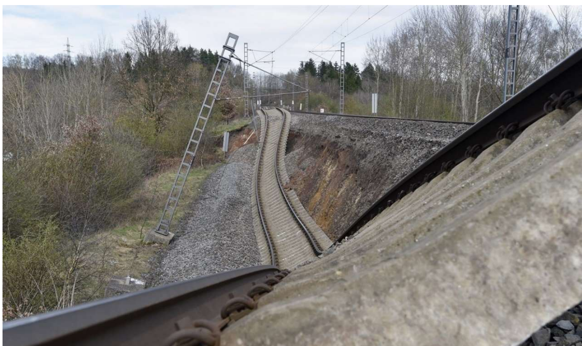
Obrázok 4.3: Poruchy spôsobené zosuvom v úseku Hájek – Dalovice v roku 2018 [12].
