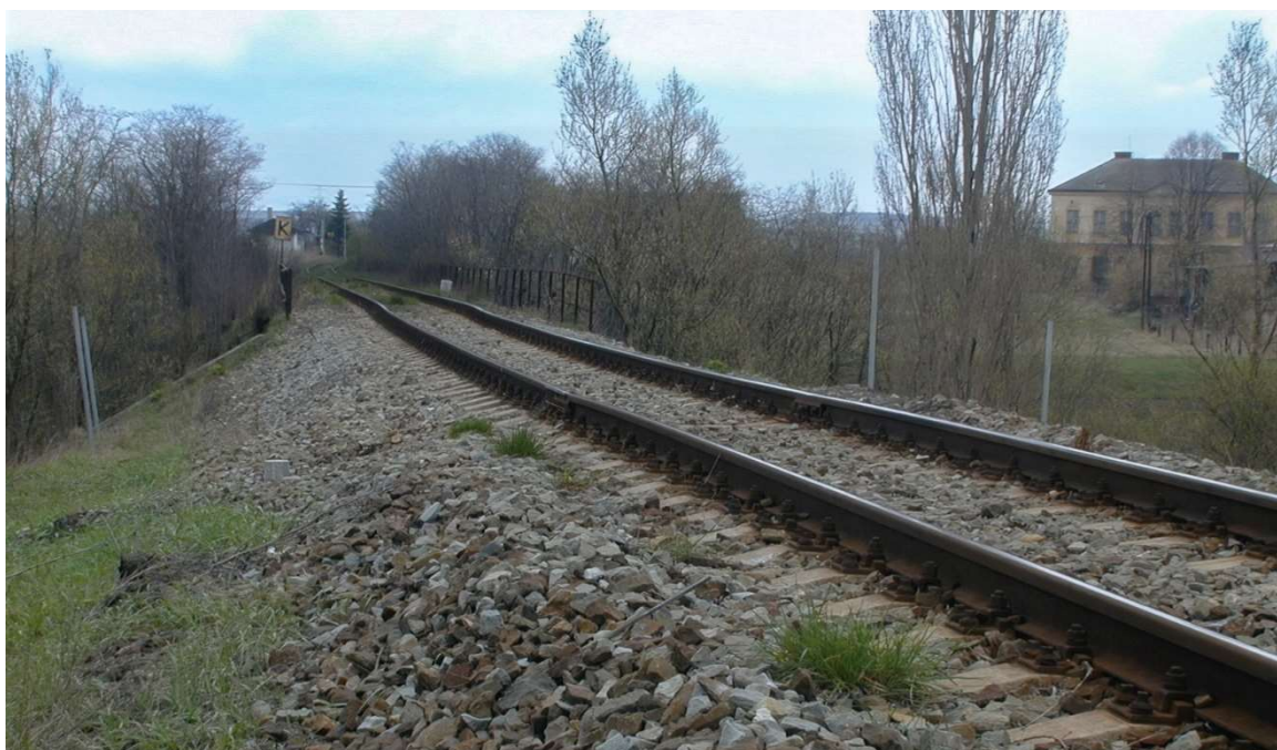
Obrázok 4.12: Viditeľné poruchy GPK v prechodovej oblasti mostu, konkrétne v km 190,286 [16].
