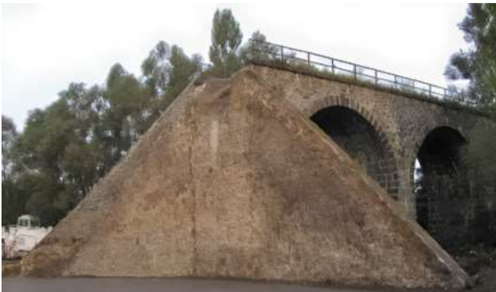
Obrázok 4.15: Poškodenie mostného krídla viditeľné po odťazení násypu [16].
