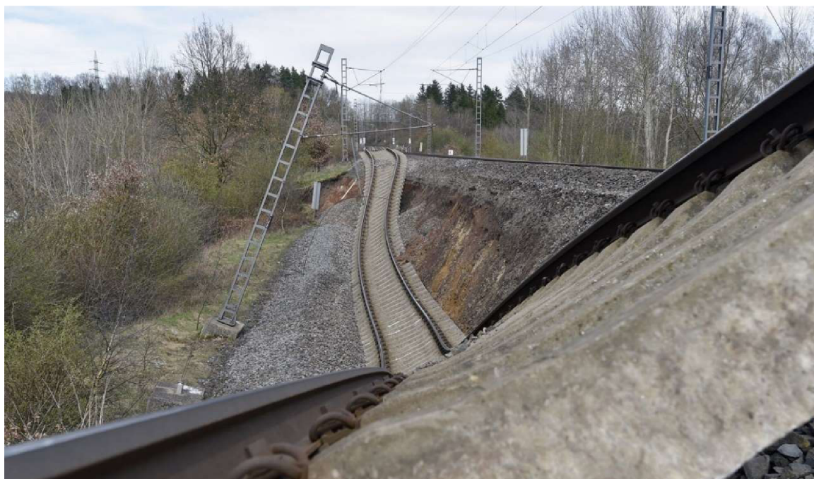
Obrázok 4.3: Poruchy spôsobené zosuvom v úseku Hájek – Dalovice v roku 2018 [12].
