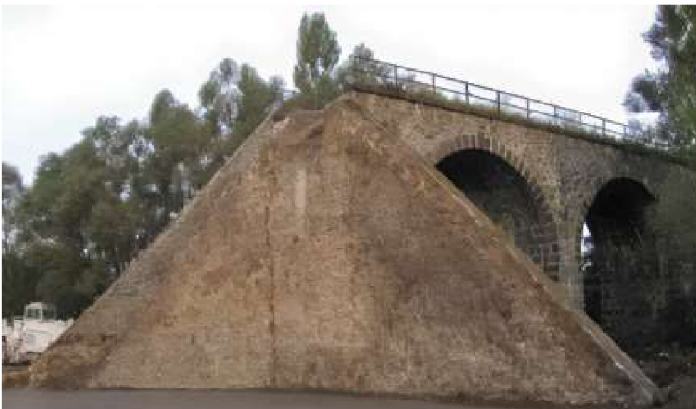
Obrázok 4.15: Poškodenie mostného krídla viditeľné po odt'azení násypu [16].
