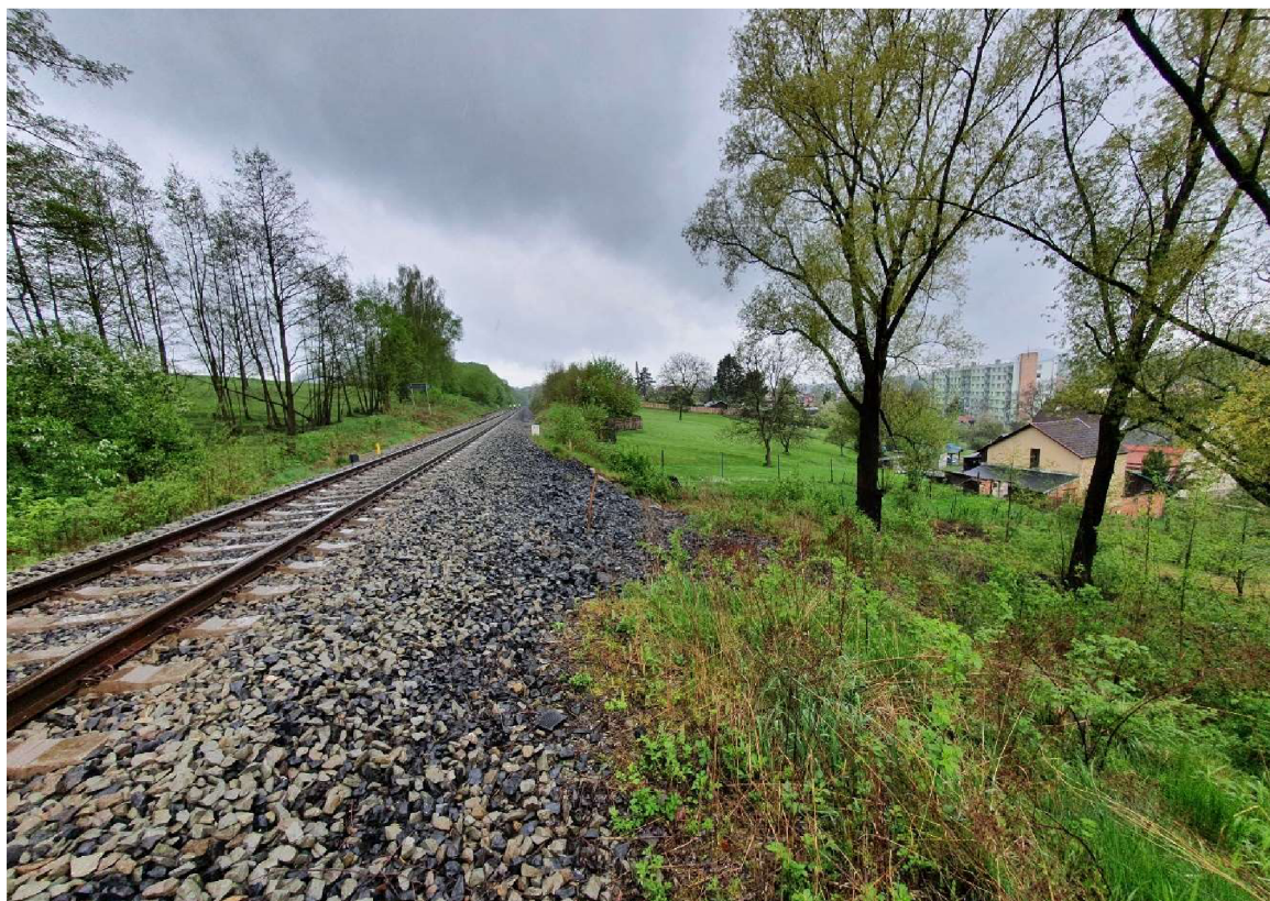
Obrázok 7.2: Pohľad na zosunutú masu štrku v smere proti staničeniu (smer stanica Česká Kamenice).
