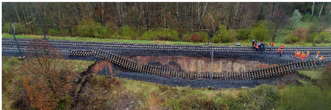
Obrázok 4.2: Poruchy spôsobené zosuvom v úseku Hájek – Dalovice v roku 2018 [11].
