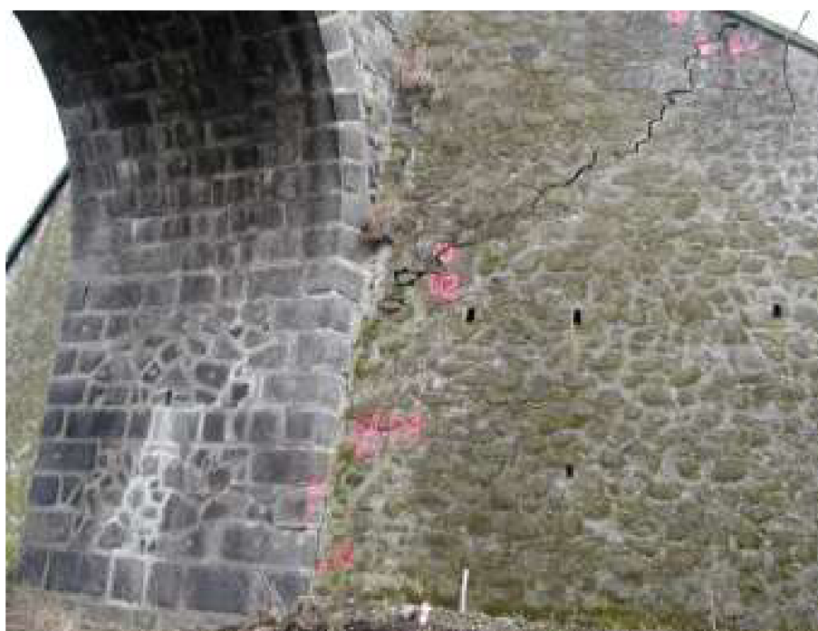
Obrázok 4.13: Poškodenie ľavého krídla mostu v km 190,286 [16].
