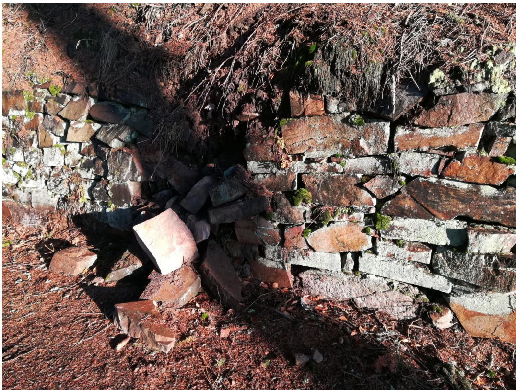
Obr. 17: Poškození opěrné zdi způsobené svahovou poruchou
