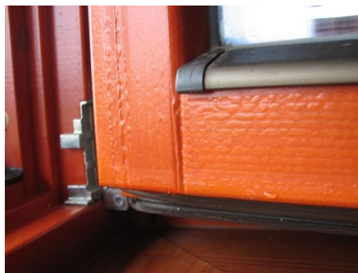
Obrázek č. 21 Počínající vlhkostní poškození lazury (převzato z [21])
