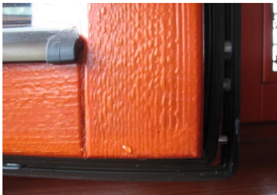
Obrázek č. 20 Počínající vlhkostní poškození lazury (převzato z [21])
