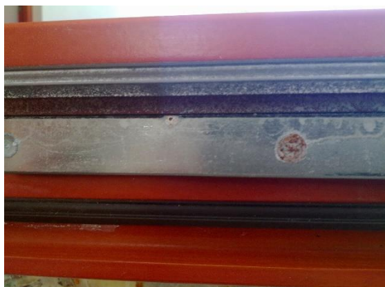
Obrázek č. 22 Poškození kování korozí
