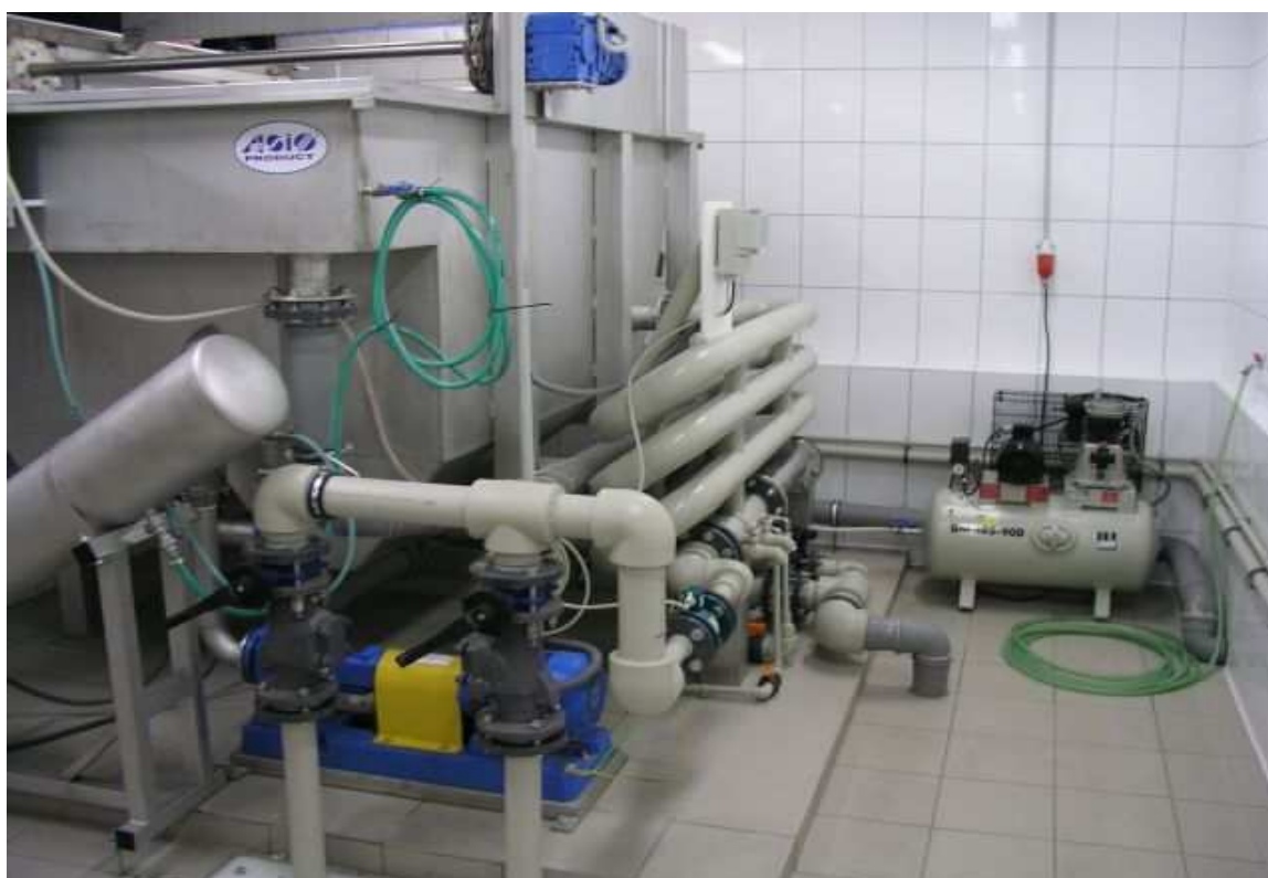
2. Flotační jednotka s trubkovým směšovačem a kompresorem
