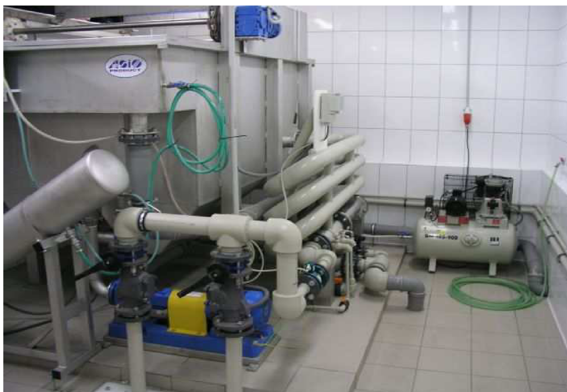
2. Flotační jednotka s trubkovým směšovačem a kompresorem
