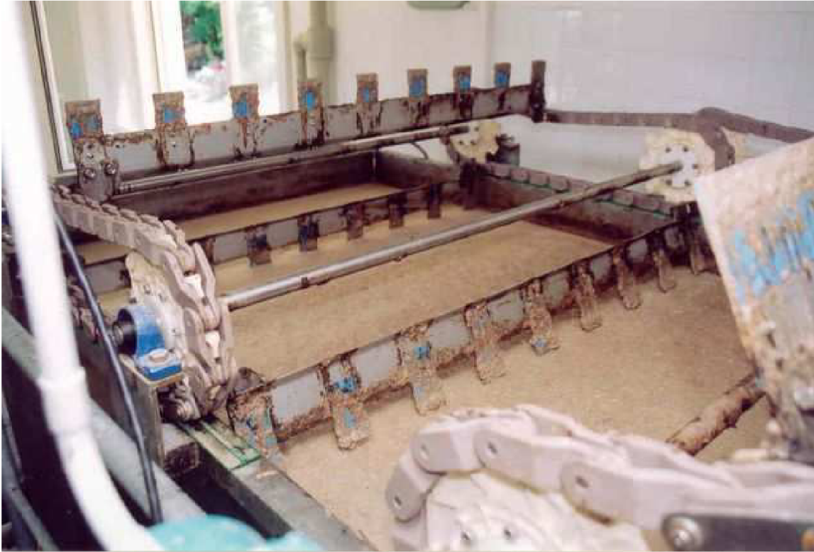
3. Detail vyflocované pěny – znečištění z odpadní vody na flotační jednotce
