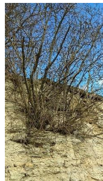
Obr. č. 117.: Strom prorůstající zdí (foto: Alena Prokopová)
