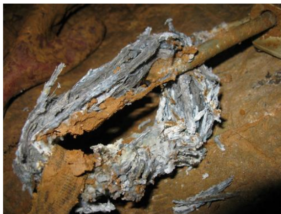
Obr. 3.7 Důsledek působení elektrochemické koroze [16]
