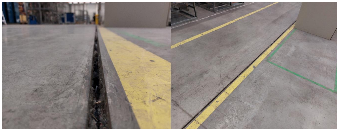
Obrázek 61 Spára mezi jednotlivými částmi podlahy
