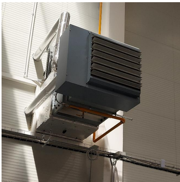
Obrázek 6 Plynová teplovzdušná jednotka
