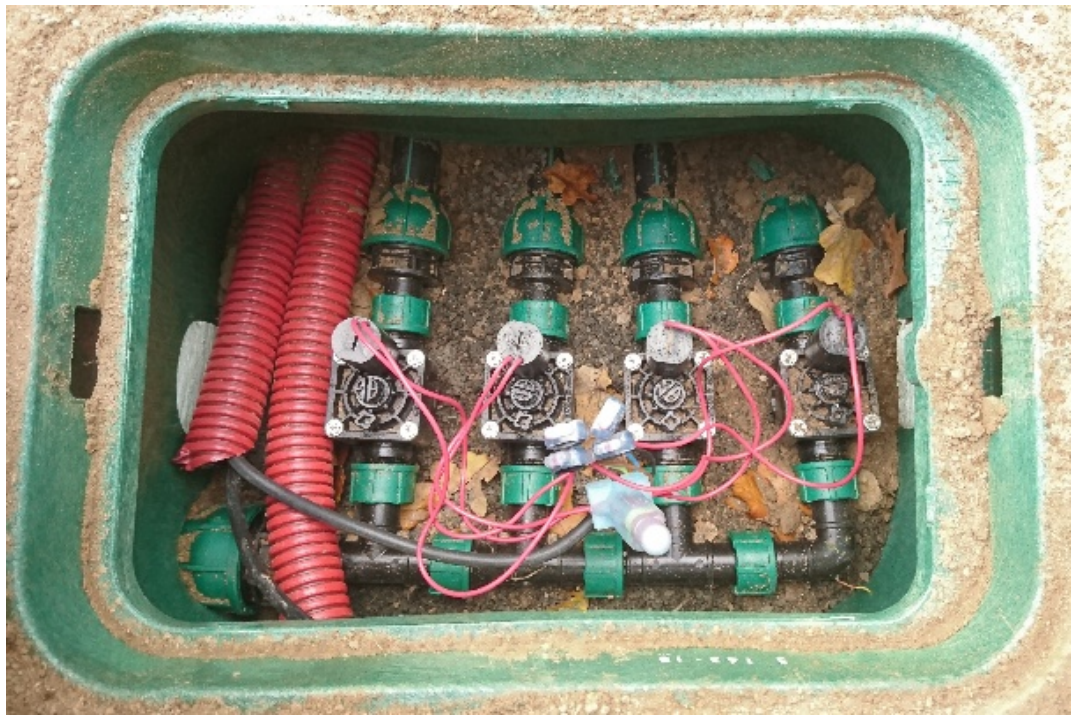
Obrázek 16 Šachtice s instalovanými elektromagnetickými ventily Hunter PGV 1" (zdroj: vlastní archiv)
