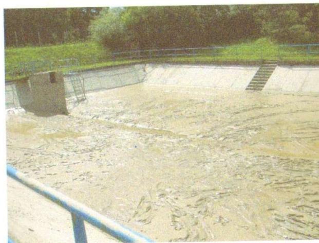
Požární nádrž (pozemek parc..č 18/3)
