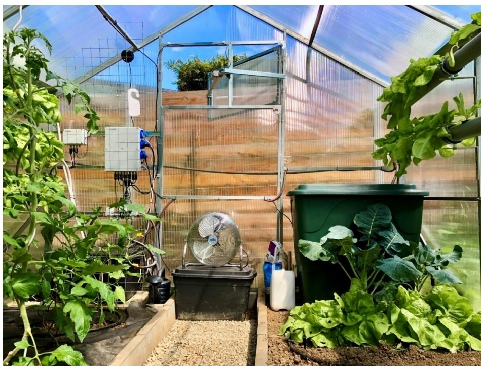
Obr. 1 Experimentální skleníků v brněnském Jundrově s instalovaným Chytrým skleníkem společnosti Sensorie (převzato z [3])
