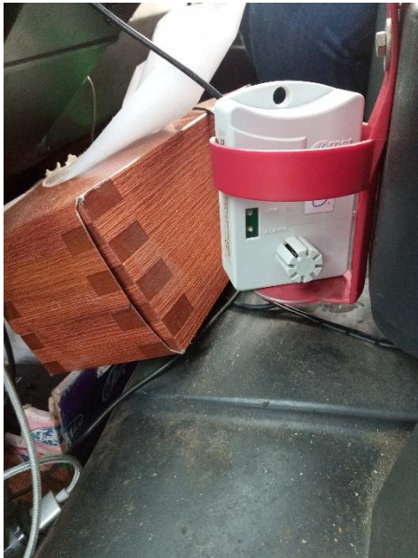
Příloha 2: Uložení dataloggerů v kabině vozu 1
