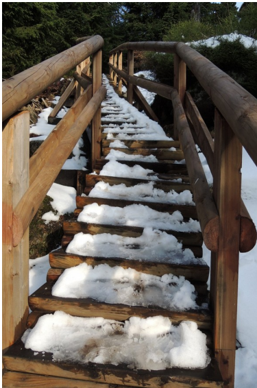
Obr. 43: Nevhodně provedené schody s příliš krátkými stupni Zdroj: autor, 2016
