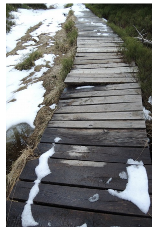
Obr. 27: Propadlá konstrukce chodníku Zdroj: autor, 2016
