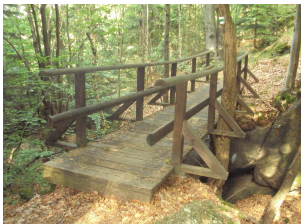
Obr. 60: Dřevěný můstek pod Oldřichovským Špičákem je v horším stavu. Zdroj: autor, 2016
