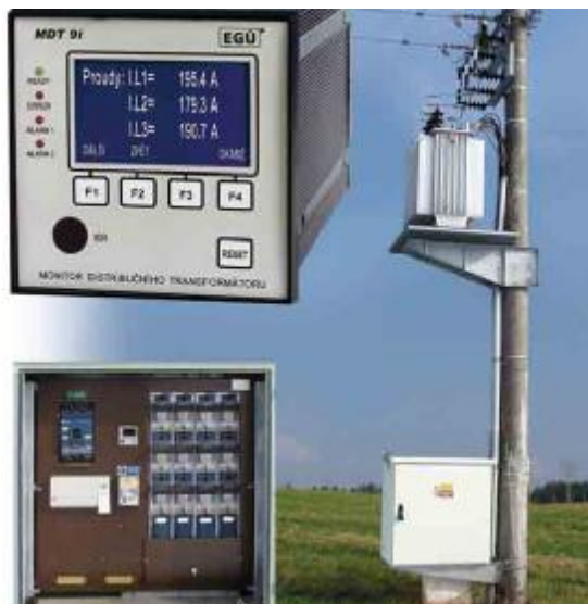
Obr. 5.5-1 Ukázka zapojení monitoru distribučního transformátoru[10]
