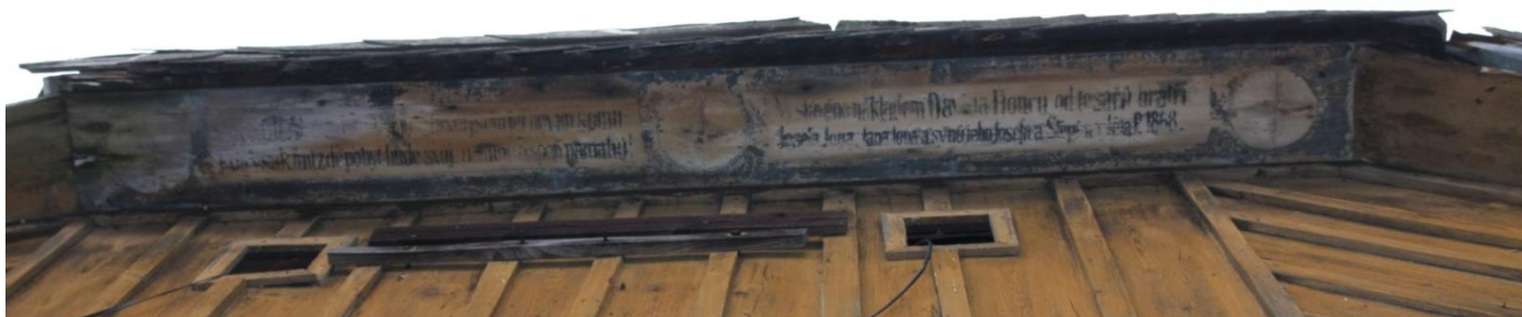
Obr. č. 23 Zákloповé prkno na stavení s č. p. 5 v Horních Štěpanicích
