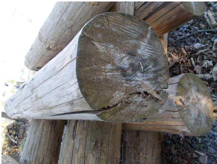
Obrázek 11 – Vytvoření výsušné trhliny
