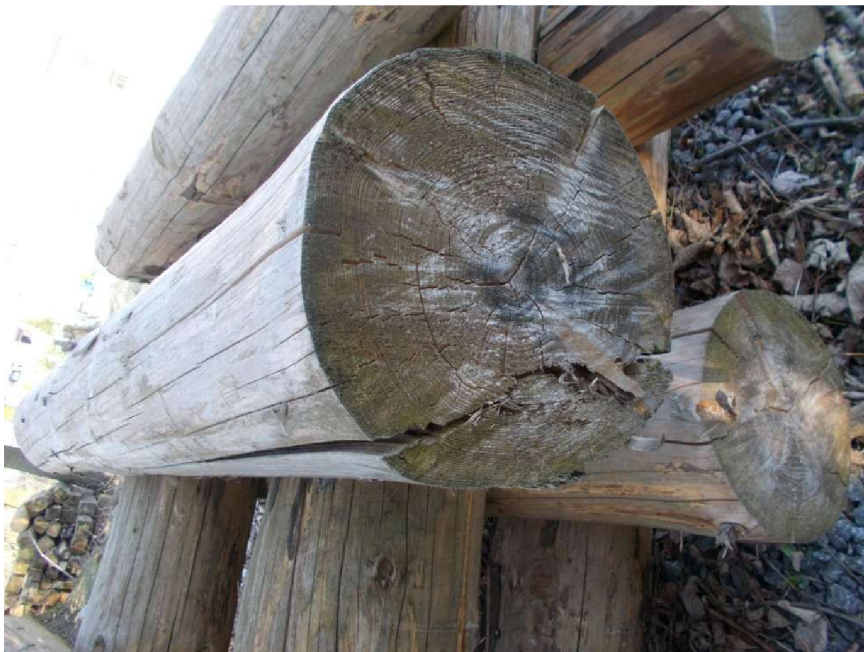
Obrázek 11 – Vytvoření výsušné trhliny
