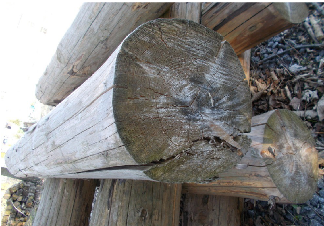
Obrázek 22 – Vytvoření výsušné trhliny Zdroj: vlastní
