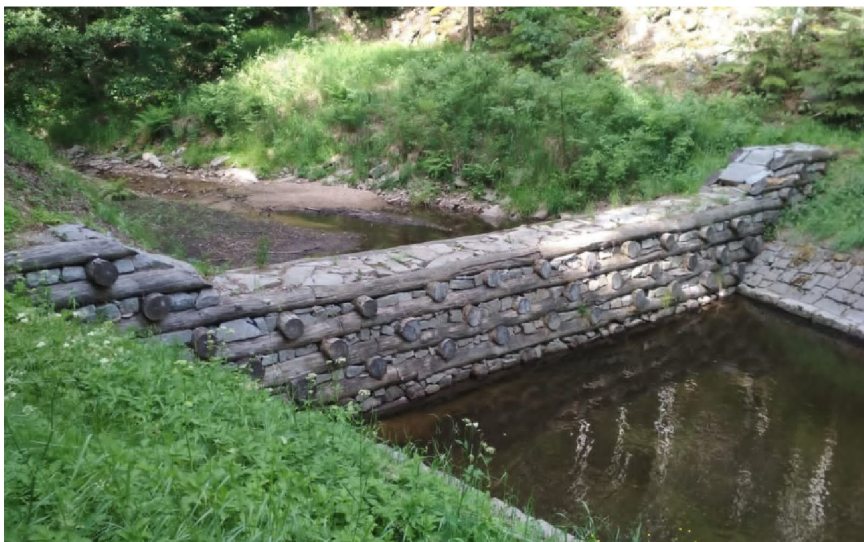
Obrázek 3 – Dřevěná srubová přehrážka
