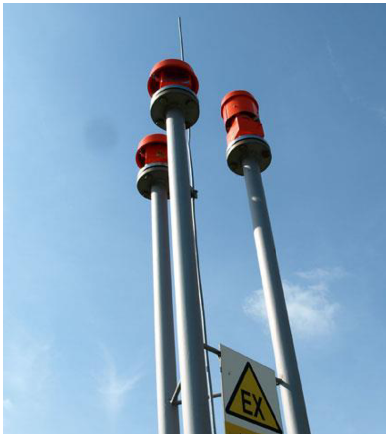
Obrázek 16: Protiexplozní pojistky na odvětrání nádrží na čerpací stanici
