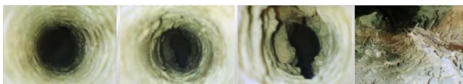
Obr. 5: Pohled do útroby dřevěného prvku pomocí videoscopického zařízení
