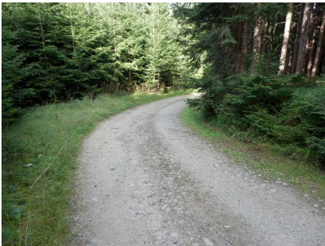
Prudká zatáčka přibližně uprostřed řešeného úseku - špatné rozhledové podmínky a nedostatečné odvodnění
