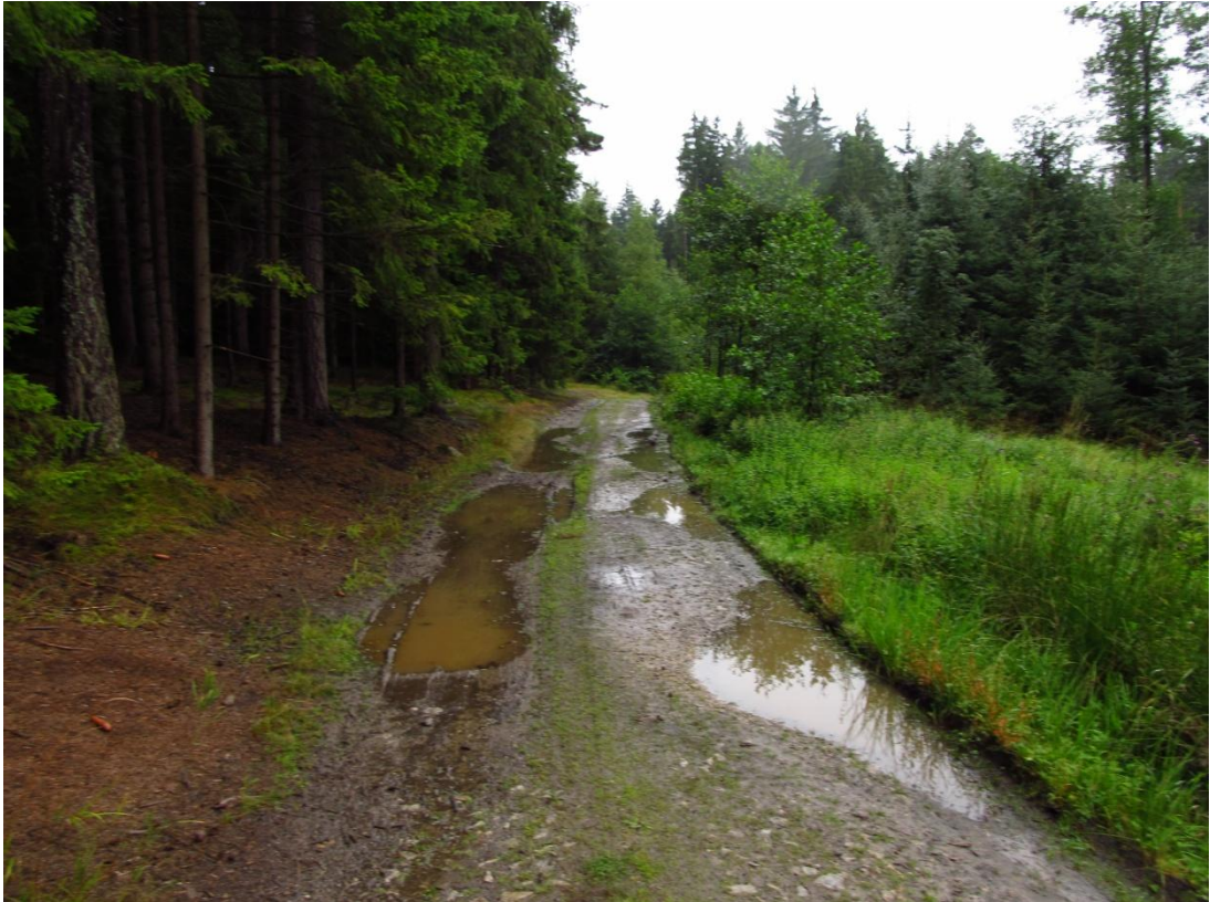
Místo se stagnující vodou na povrchu cesty a chybějící podélné a příčné odvodnění
