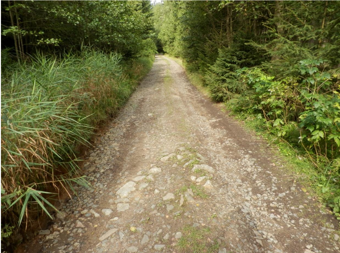
Současný stav lesní cesty - vyjeté koleje a nedostatečné odvodnění povrchu
