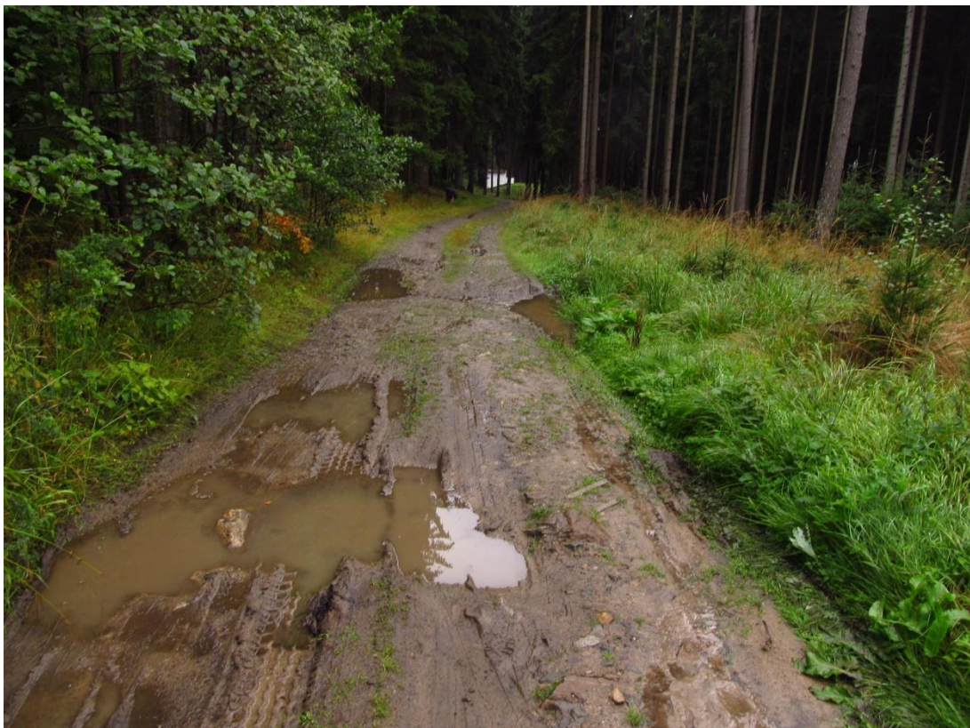
Stagnující voda na povrchu cesty a vpravo potenciální místo první skládky
