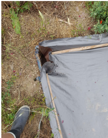
Obrázek 43 - poškození sedimentační jímky č. 2, zdroj vlastní
