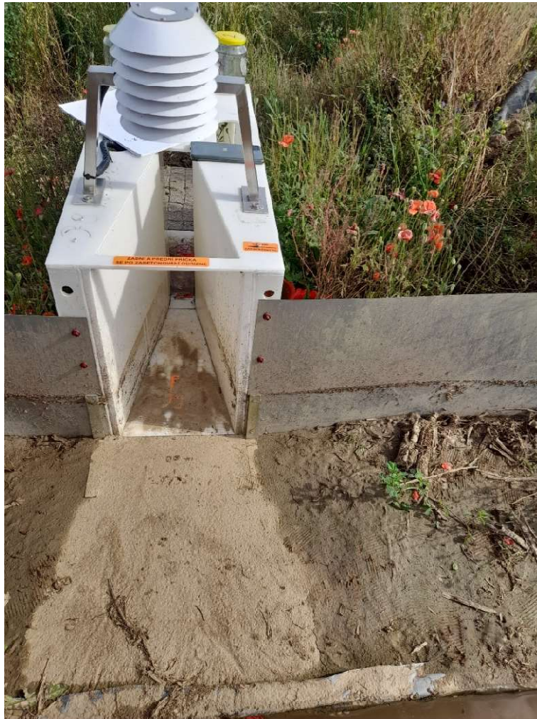
Obrázek 45 - výška hladiny vody, jímka č. 2 - zdroj vlastní
