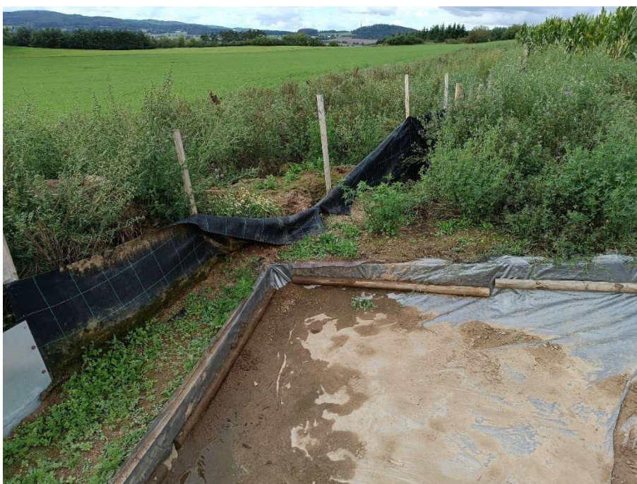
Obrázek 49 - porušení svodné geotextilie - zdroj vlastní
