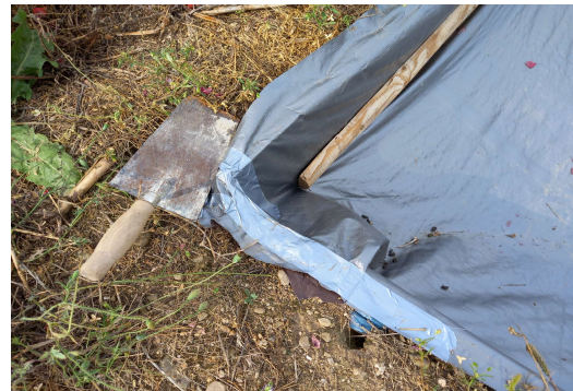
Obrázek 44 - oprava rohu sedimentační jímky univerzální páskou, zdroj vlastní
