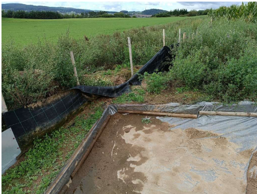
Obrázek 49 - porušení svodné geotextilie - zdroj vlastní
