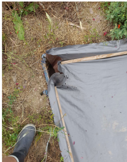
Obrázek 43 - poškození sedimentační jímky č. 2, zdroj vlastní
