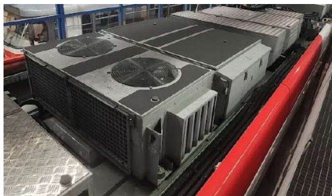
Obr. 2. 27 Klimatizační jednotka Konvekta (Foto autor)
