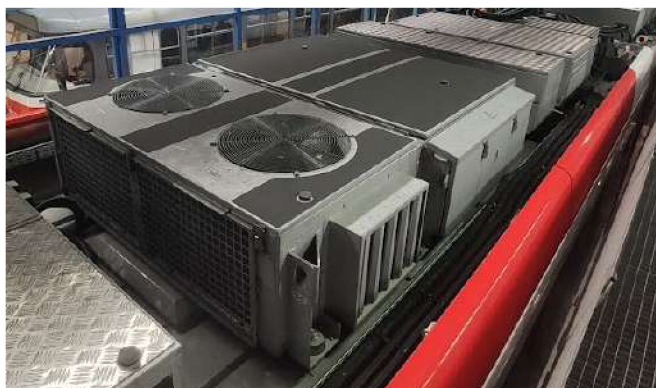
Obr. 2. 27 Klimatizační jednotka Konvekta (Foto autor)
